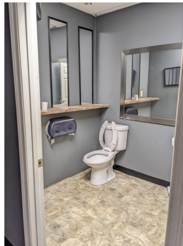
Inaccessible toilet room
